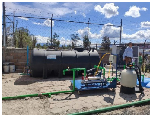
Planta de Tratamiento de Aguas Residuales (PTAR) Canal de Chalco
